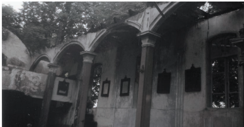
Zdjęcie wnętrza kościoła po pożarze, 11.07.1994 r., fot. Jan Tomasiak
